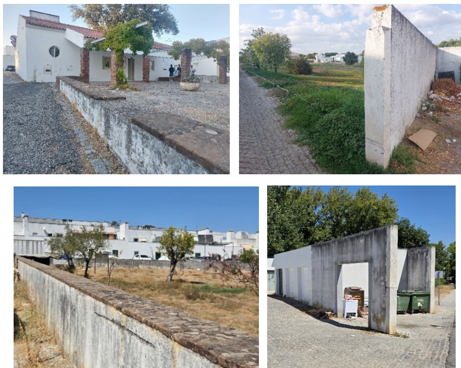
Figs. 66, 67, 68 e 69 – Exemplos atuais de muretes com capeamentos em falta, com topos em mármore quebrados, com pinturas degradadas.
