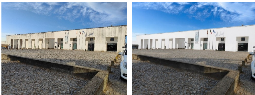
Figs. 62 e 63 – Conduta enquadrando a Junta de Freguesia, na Praça Zeca Afonso, denunciando a falta de uniformidade e deterioração de pinturas, à esquerda, e como se imagina no amanhã, com devida pintura dos elementos, à direita (imagem manipulada com recurso a ferramentas de IA)
