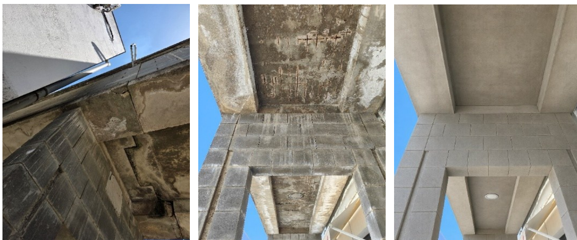
Figs. 56, 57 e 58 – Conduta com infiltrações, à esquerda, e com armaduras expostas, ao centro, e como se imagina no amanhã, com devido tratamento da estrutura, à direita (imagem manipulada com recurso a ferramentas de IA)
