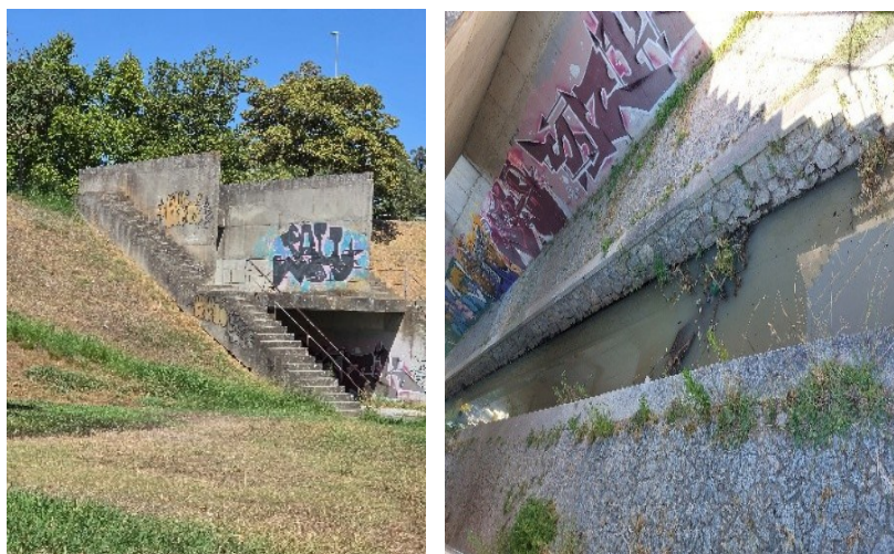
Figs. 72 e 73 – Exemplos atuais de pichagens e grafitação generalizada de muros externos e internos do pontão.
