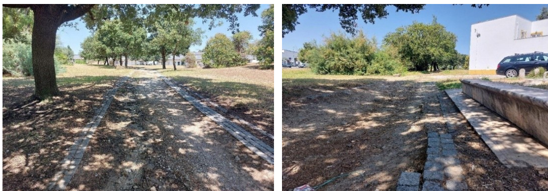
Figs. 9 e 10 - Caminhos de saibro intransitáveis, ravinados e erodidos em profundidade, com valetas com falta de cubos, obstruídas, sem qualquer iluminação pública lateral em funcionamento
