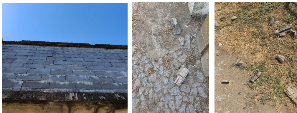
Figs. 59, 60 e 61 – Perda de betão nas lajetas de cobertura, como se verifica hoje, à esquerda, com desperdícios de betão caídos no solo, ao centro e à direita.
