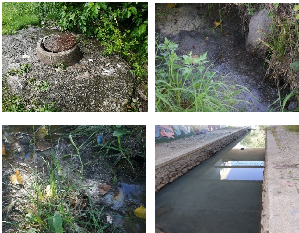
Figs. 74, 75, 76 e 77 – Exemplos ocorridos de transbordo de águas residuais e de escorrências de águas saponadas.
